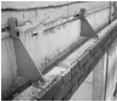
Bild 16 Befestigung eines Fertigsturzes mit der tragenden Betonwand durch Winkelkonsolen; in diesem Fall dient der Sturz als Auflager für das Verblendmauerwerk
