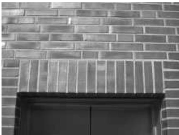
Bild 6 Schwachstelle des Verblendmauerwerks: Stürze aus gemauerten Grenadierschichten
