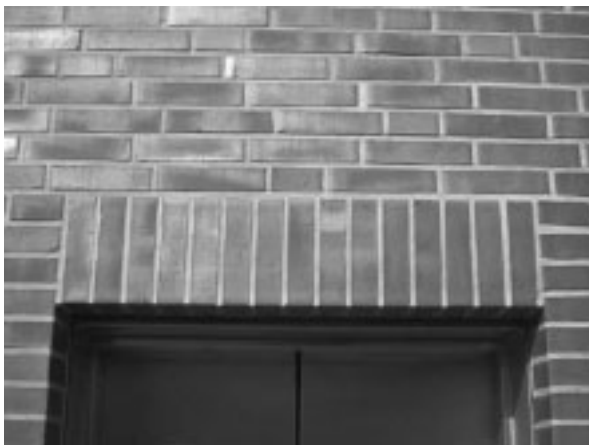
Bild 6 Schwachstelle des Verblendmauerwerks: Stürze aus gemauerten Grenadierschichten
