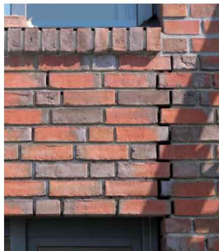
Bild 6. Selbst die Dehnfuge zur Trennung des Brüstungsfertigteils und dem angrenzenden Mauerwerk kann mäandrierend ausgebildet werden Fig. 6. Even the expansion joint to separate the parapet finished part and the adjacent walls can be designed meandering
