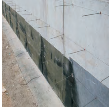
Bild 13. Die Perforierung der Abdichtungsbahnen durch Drahtanker ist meist unvermeidbar, da die erste Ankerlage so tief wie möglich anzuordnen ist
