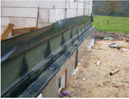
Bild 11. Schweißbahnen werden immer wieder zur Abdichtung des Sockelmauerwerks von zweischaligen Außenwänden verwendet, obwohl sie in DIN 18195-4 für waagerechte Abdichtung in und unter den Wänden nicht geführt werden. Die Drahtanker sind zu hoch angeordnet worden. Um ein Abrutschen der Verblendschale über ihr Auflager zu verhindern, sollen die Drahtanker so tief wie möglich angeordnet werden. Eine Perforierung der Abdichtungsbahnen durch Drahtanker ist daher unvermeidbar und unbedenklich. Die Durchdringungen sollen dennoch nach DIN 18195-9 nachträglich abgedichtet werden
