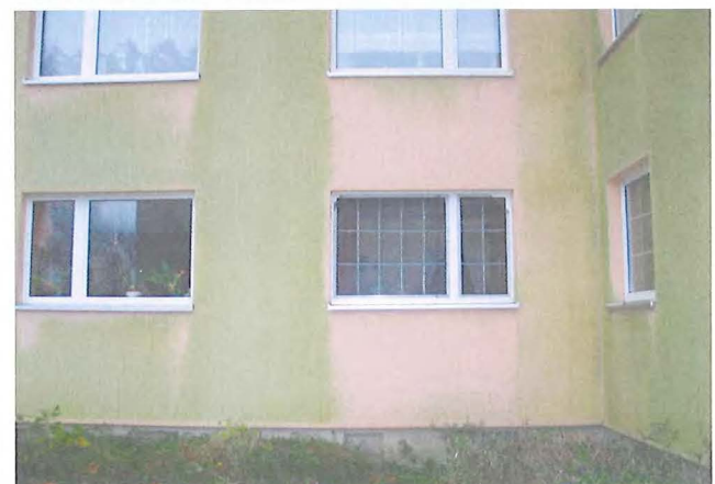
Beispiel einer stark algenbesiedelten Fassade in Kiel, Sanierung im 2000
