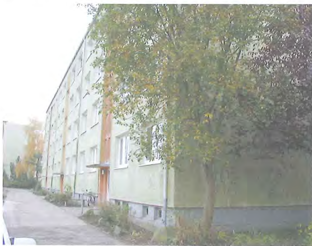
Bild 7 Dicht wachsende Pflanzen verhindern den Feuchtigkeitstransport und erhöhen den „Biodruck“ an der Fassade
